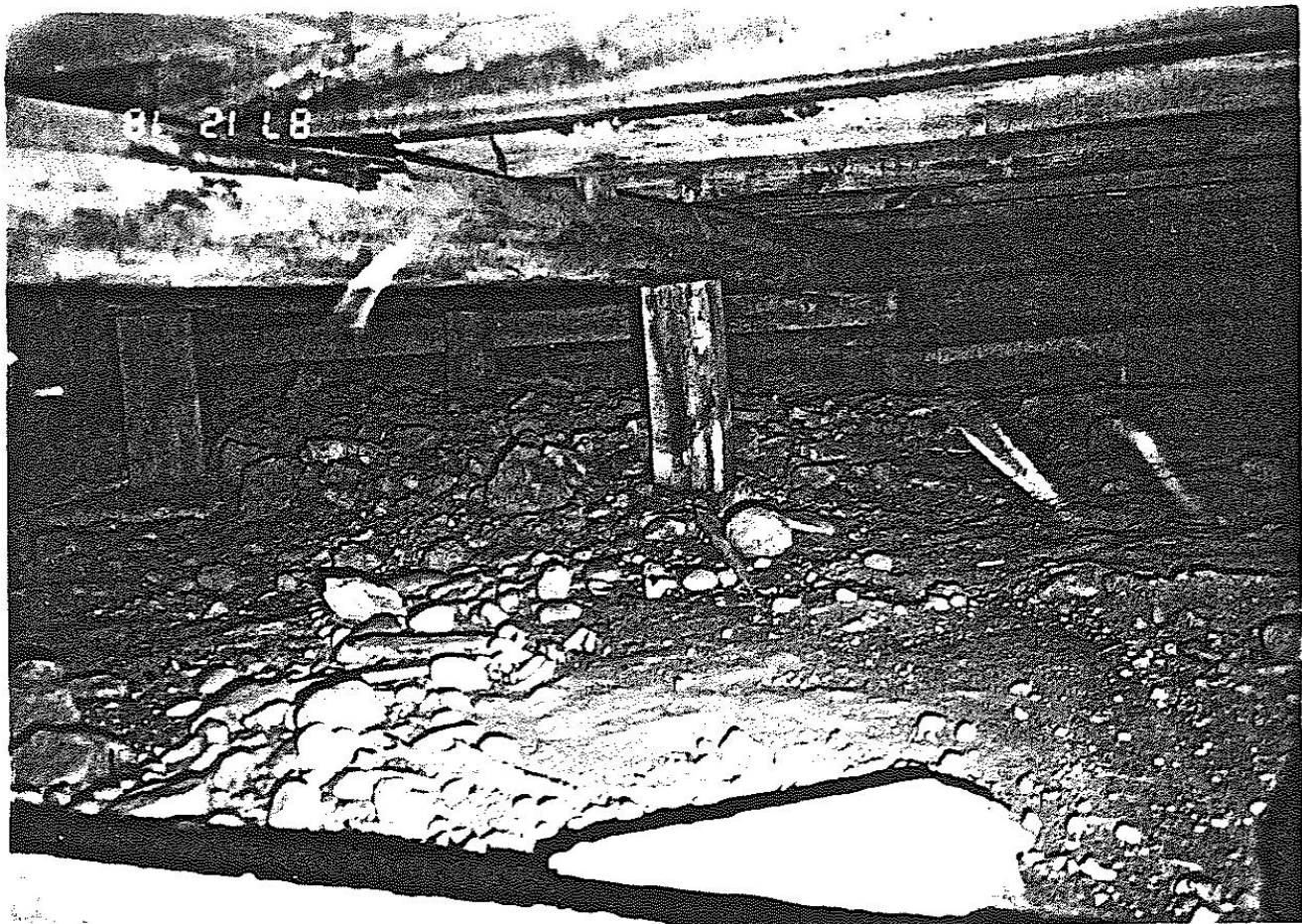
夕 星溪寮 和室床下
