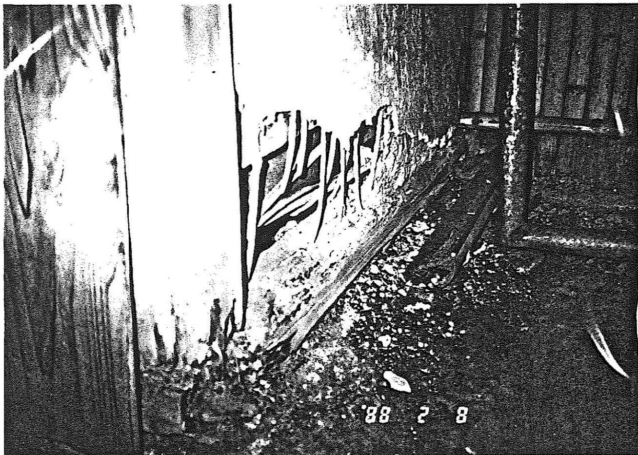
外壁(土塗壁) の破損
