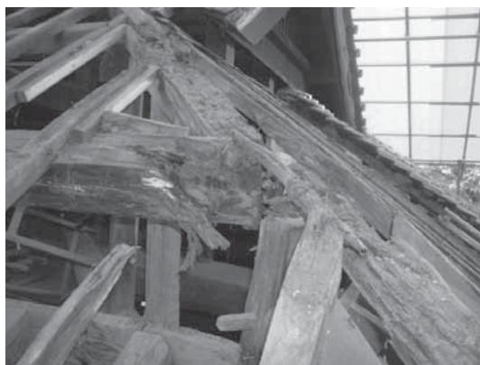
22 隅木廻り 腐朽状況
