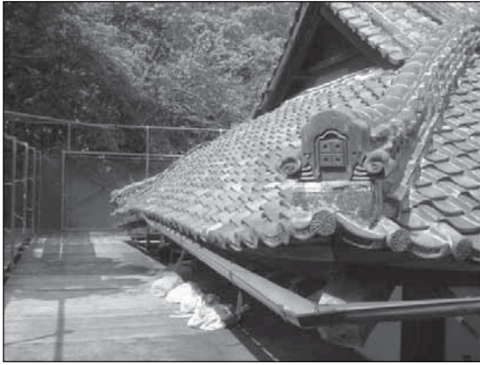
屋根破損状況 1
