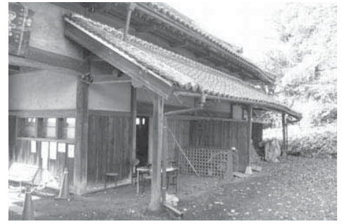
北側西部屋前 下屋破損状況
