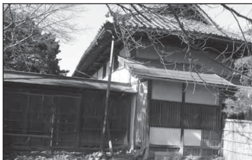
東南隅 化粧隅木折損に伴う鉄骨角パイプ補強
