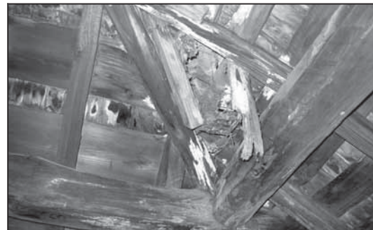
東南隅 小屋裏野地板廻り破損状況
