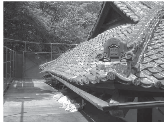
16 修理前 南西隅
