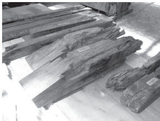
24 隅木腐朽状況
