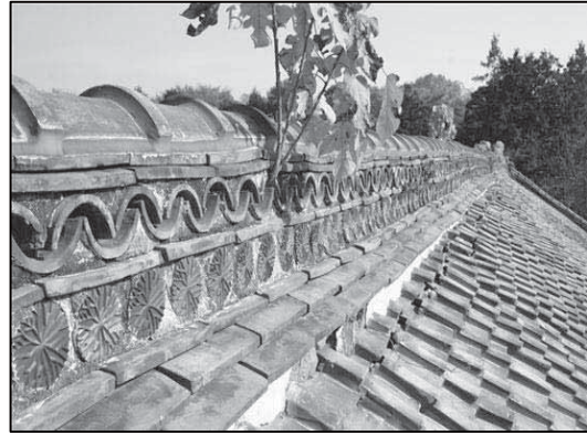
屋根破損状況 2
