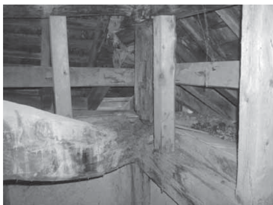
21 隅木廻り 腐朽状況
