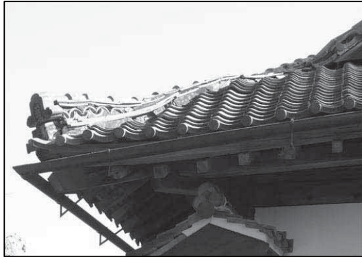
屋根破損状況 3
