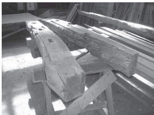
23 隅木腐朽状況
